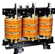
浄水場用 高圧受電用変圧器
